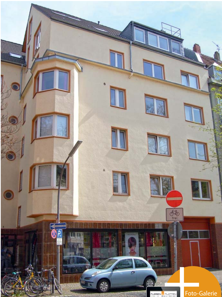
Gerissene Fliesen und veraltetes Erscheinungsbild: Die Erdgeschossfassade dieses Kölner Wohn- und Geschäftshauses sollte neu verkleidet werden.
